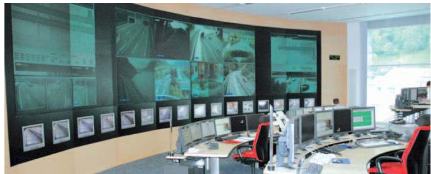
Blick in die Leitwarte am St. Gotthard
